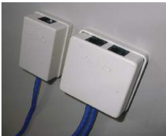
Figura 40: Tomadas de rede em caixas externas.
