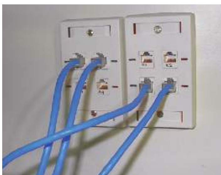
Figura 39: Tomada de rede embutida na parede
